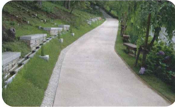
低蓄熱性の特徴をもつ瓦を利用した舗道。 表面温度がアスファルトより十数度低い。
