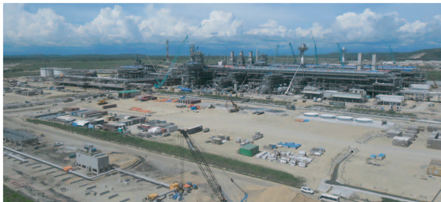
パプアニューギニアのLNGプラント
